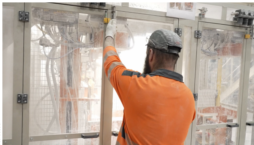
Air plus sain pour les équipes en production grâce à l'ajout de portes vitrées
